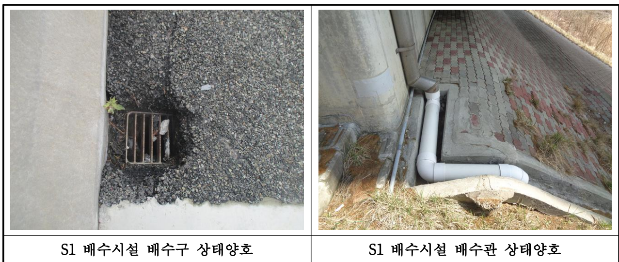
【사진 3.22】 배수시설 손상현황
