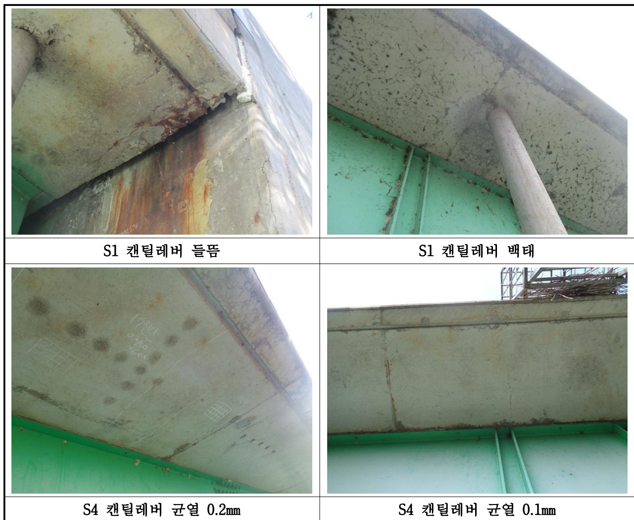
【사진 3.3】 바닥판 손상현황
