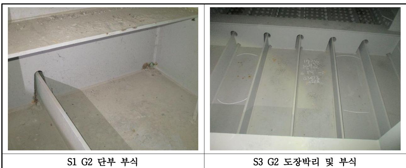
【사진 3.6】강박스 거더 내부 손상현황
